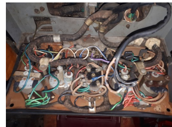
Center Dash Wiring
